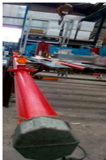
Ramal con rociadores
