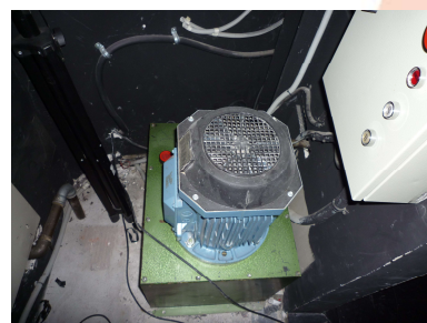
Pistones con bomba hidráulica
