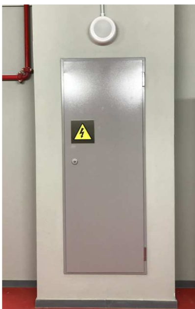
Registro para instalaciones
