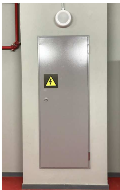
Registro para instalaciones
